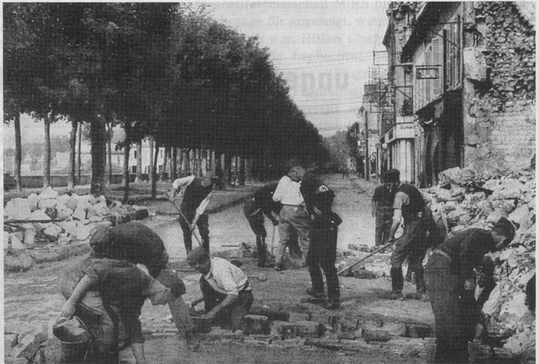
Überall müssen Bombenschäden beseitigt werden
